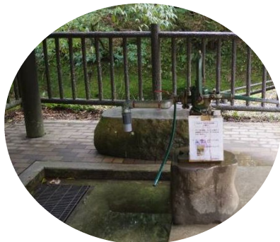
階段上の脇にある手押しポンプ。湧き水をくみ上げることができる。
